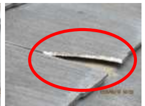
割られたスレート
