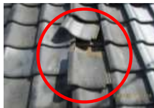
剥がされた瓦
